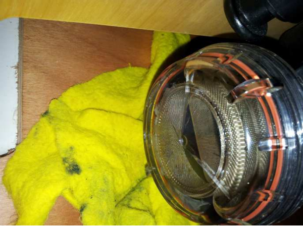
Çatlak hidrofor filtre kapağı, Dubrovnik
